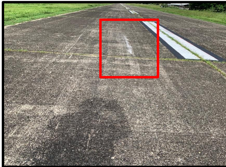
Fotografía No. 15 Marcas dejadas en la pista por el fuselaje y la hélice.
